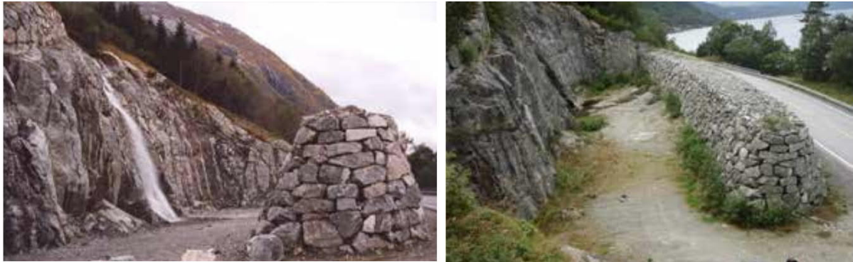
Figur 8.29 Foto av fangvoll med bratt tørrmur på begge sider, Rv. 7, Indre Rotagjelet, Hordaland. Foto: H. Norem
